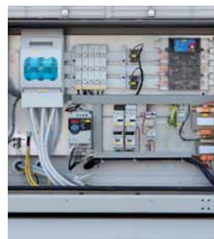
Elektroschaltschrank mit Anschluss
