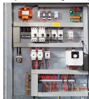
Elektroschaltschrank mit Anschluss
