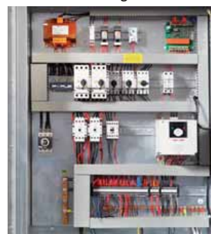
Elektroschaltschrank mit Anschluss
