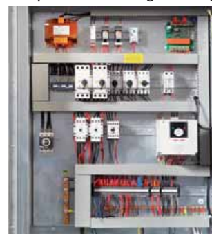
Elektroschaltschrank mit Anschluss
