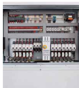
Elektroschaltschrank mit Anschluss
