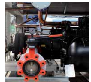
Kaltwasseranschluss mit Storz-Kupplungen
