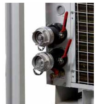
Kaltwasseranschluss mit Storz-Kupplungen
