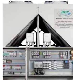
Elektroschaltschrank mit Anschluss
