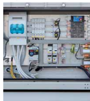
Elektroschaltschrank mit Anschluss
