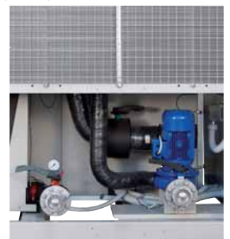
Kaltwasseranschluss mit Storz-Kupplungen
