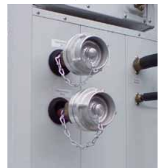
Kaltwasseranschluss mit Storz-Kupplungen
