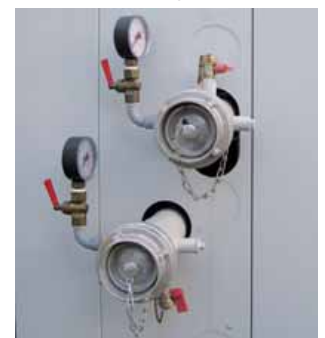
Kaltwasseranschluss mit Storz-Kupplungen
