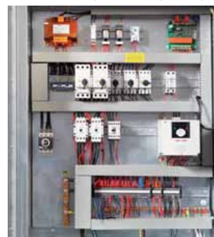
Elektroschaltschrank mit Anschluss
