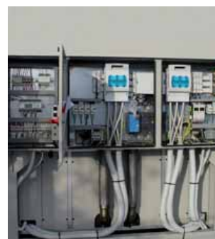
Elektroschaltschrank mit Anschluss
