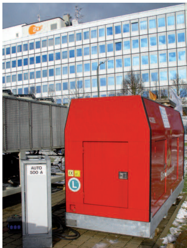
Notstromversorgung mit einer Dauerleistung von 300kVA
