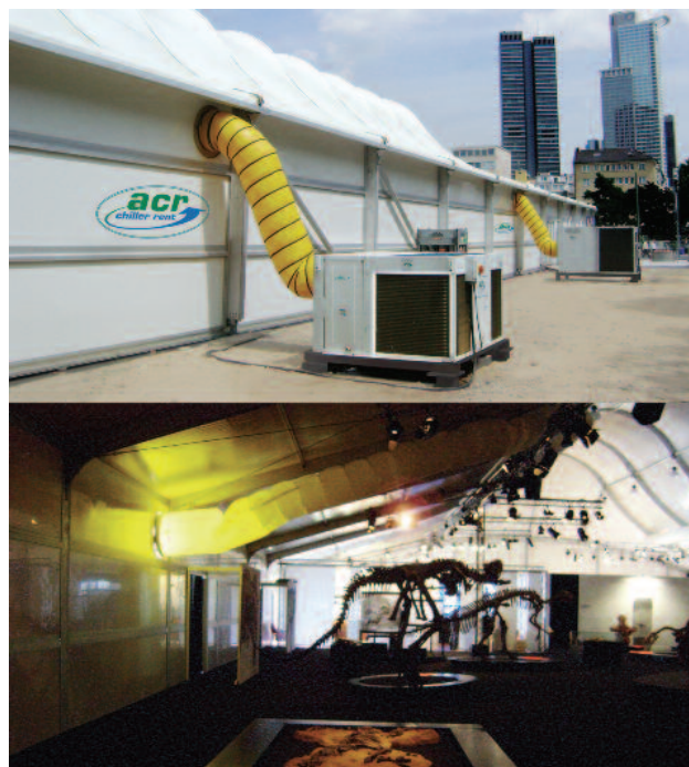
Installierte Rooftopeinheiten und Luftverteilung im Zelt (© Fotos: acr)
