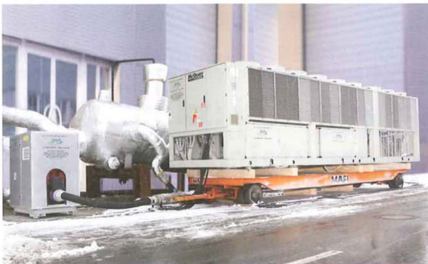
Mietflüssigkeitskühler mit einer Kälteleistung von 1.600 kW / je Einheit sowie ein Pumpenmodul mit einer Förderleistung von 230m 3 /h. Im Hintergrund die hydraulische Weiche mit einem Volumen von 10.000 Liter. (Foto: acr chiller rent)
